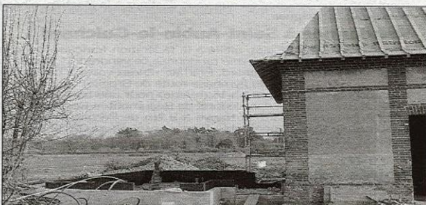
Le local technique situé au nord-est et qui jouxtera le gîte s'élève doucement depuis que le drainage périphérique a été réalisé. Les eaux recueillies sont refoulées vers la mare et serviront à l'arrosage des serres.
